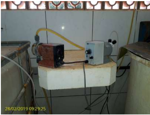
Foto 31 - Deve-se fixar as bombas dosadoras sobre superfície resistente e identificar cada uma delas.
