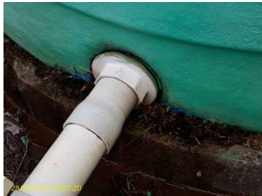
Foto 60 - Vazamento no flange
