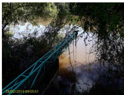
Foto 10 - Suporte para o mangote que abriga a bomba submersa também.
