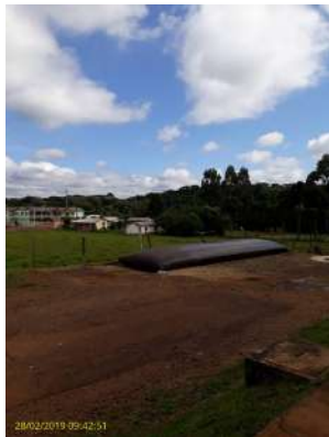
Foto 12 - Há vazamento em um dos bag de desidratar o lodo
