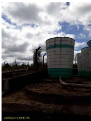
Foto 64 - Não há isolamento da área
