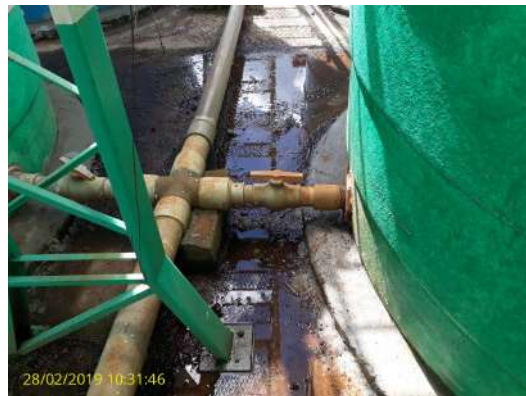
Foto 69 - Vazamento nas tubulações
