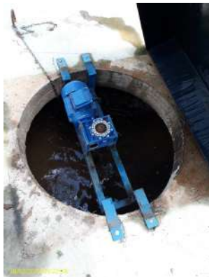
Foto 21 - Bomba com capacidade limitada (30l/s)
