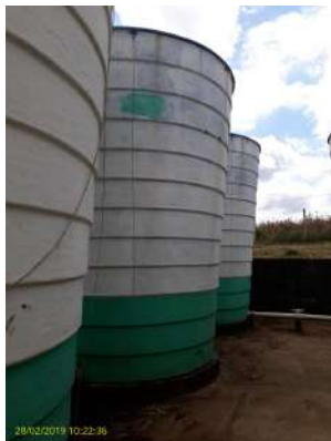
Foto 63 - Reservatórios em fibra
