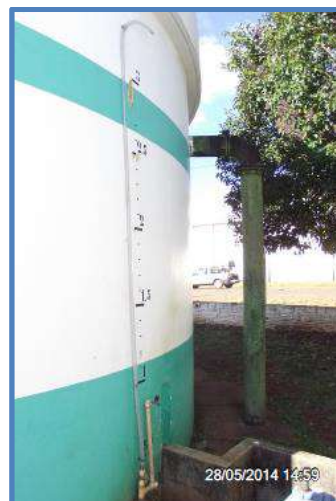
Imagem 23: Dispositivo medidor de nível dos Reservatórios R 01.
