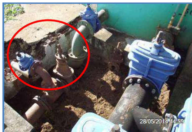
Imagem 19: Caixa dos registros de manobras dos Reservatórios R 01.
