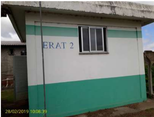
Foto 44 - Estrutura civil ERAT
