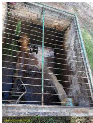
Foto 32 - A sobra da água da lavagem dos filtros é destinada para os rios, pois a bomba não tem capacidade para enviar o lodo todo para os bag
