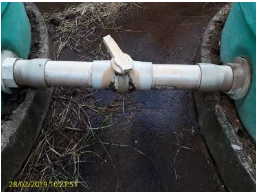
Foto 59 - Vazamento no registro
