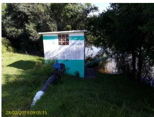
Foto 9 - Adutora de água bruta
