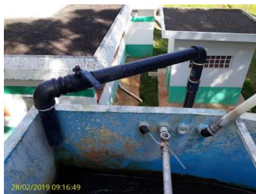
Foto 16 - Entada da água do retorno dos bag. Está desativado, pois o polímero estava entupindo os filtros. Portanto, a água está sendo dispensada no rio após tratamento.
