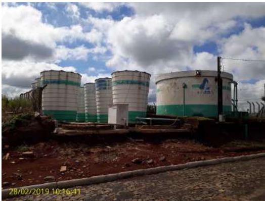
Foto 61 - Conjunto de reservatórios
