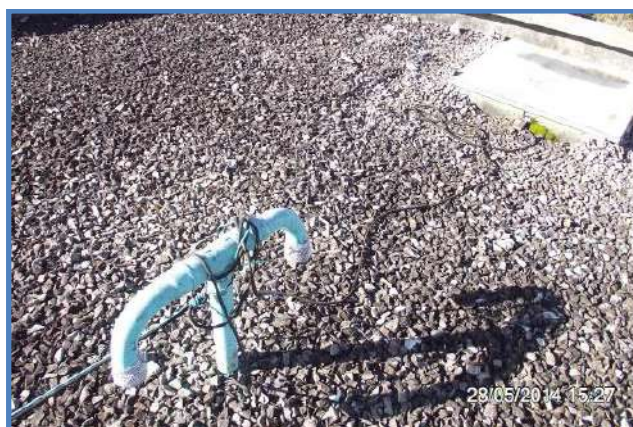
Imagem 29: Fiação elétrica junto aos dutos de ventilação do Reservatório R 02A.
