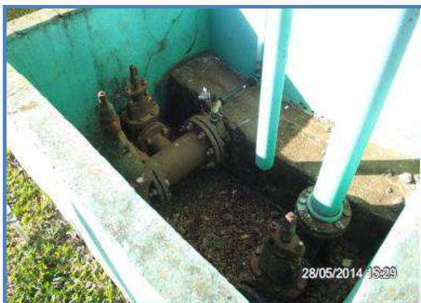
Imagem 32: Caixa dos registros de manobras do Reservatório R 02A.
