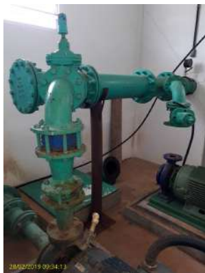
Foto 40 - Pintura em condições aceitáveis
