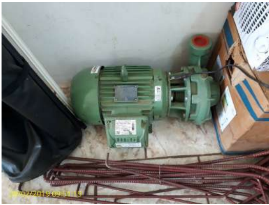
Foto 2 - Bomba reserva em estoque
